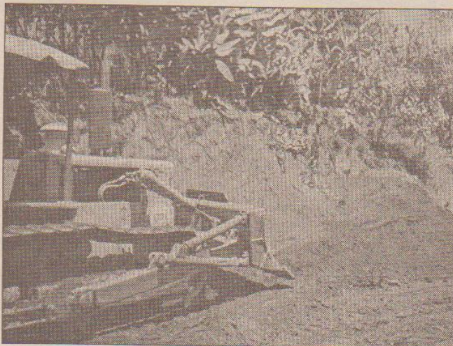
La ampliación de la vía ha producido la destrucción de los árboles sembrados en la finca de la familia Guevara. (Foto: Beatriz Erazo)
